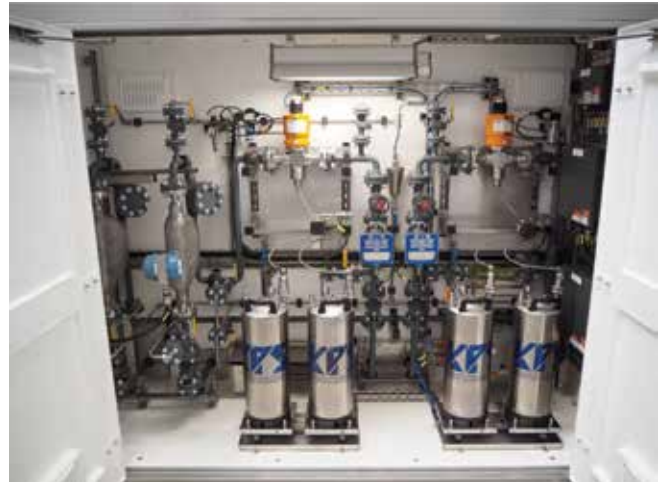
Fot 5. Wnętrze szafy próbopobieraka z pojemnikami na próbki
