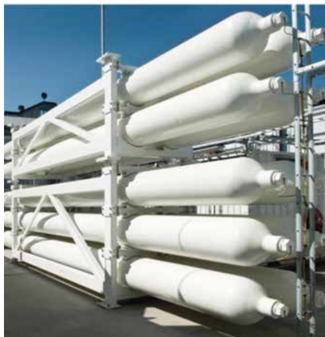
Zbiorniki na wodór sprężony
