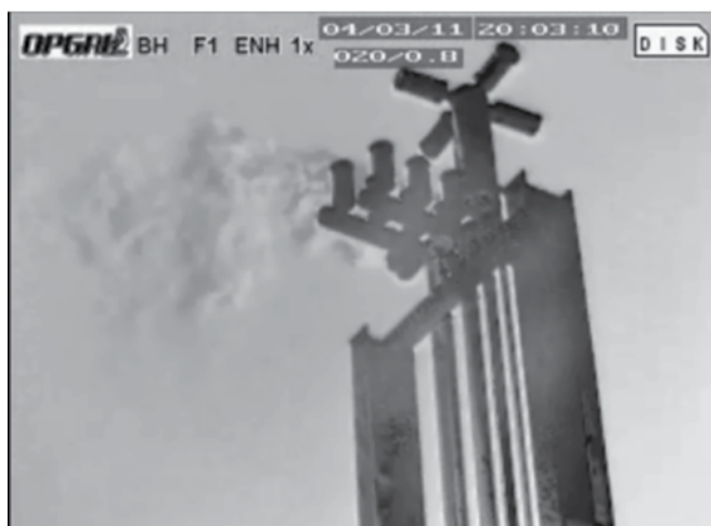
Rys.6 Zdjęcie obrazujące wyciek na instalacji.
