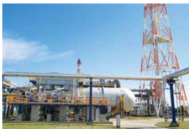
Fot. 1. Instalacja odzysku gazu opałowego w firmie Lotos S.A. 1
