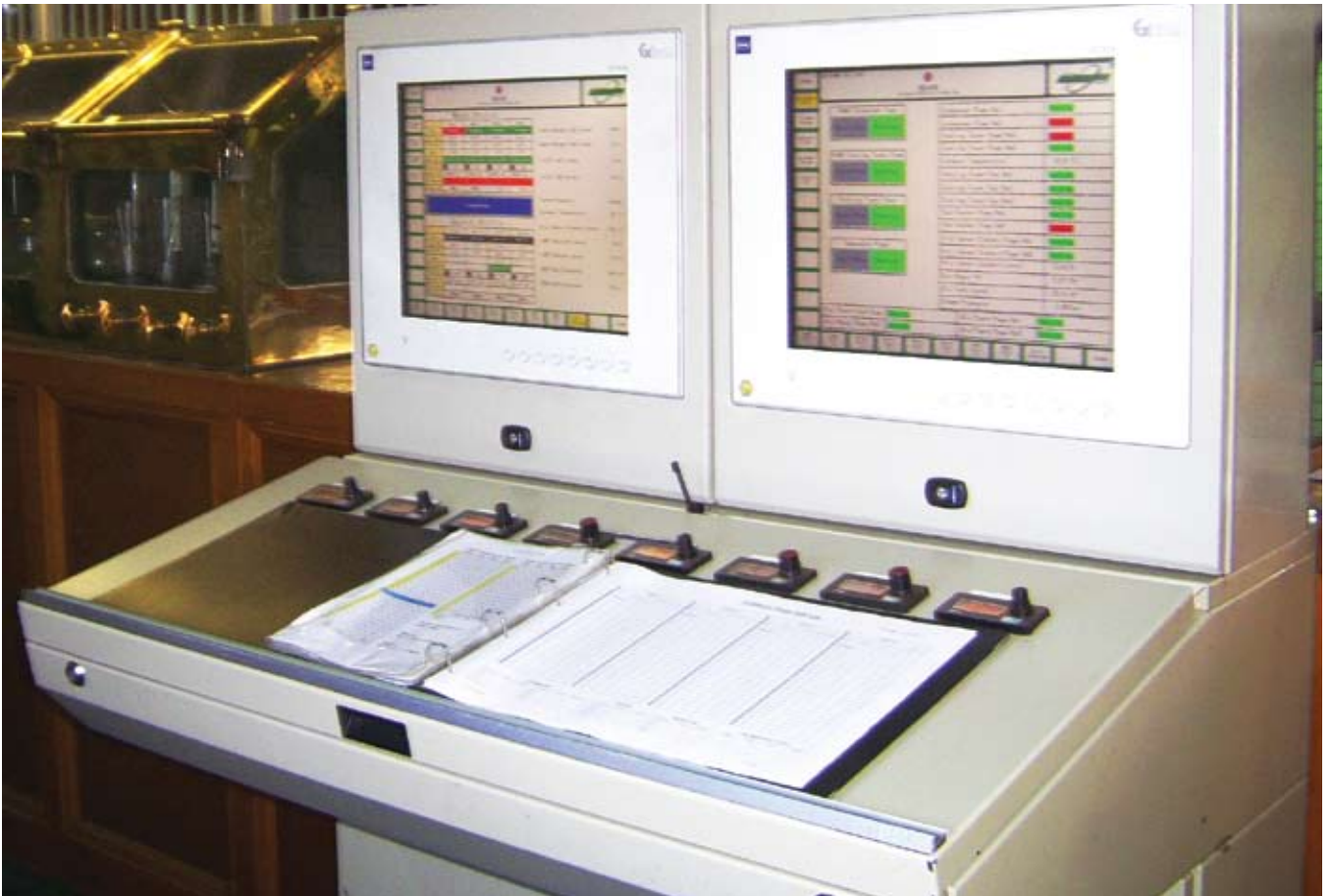
Fot. 1. Systemy HMI firmy R. STAHL zainstalowano obok „sejfu” (po lewej stronie), czyli szklanej szafki zabezpieczonej kłódką, do której trafia alkohol z destylatorów
